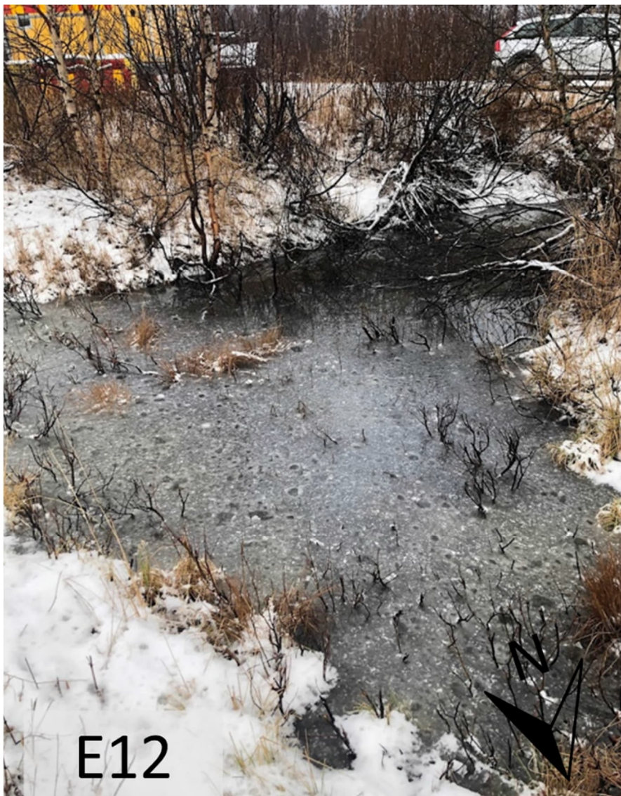
Figur 11. Bild från genomfört platsbesök (November, 2021). Vatten står mellan trumman under väg E12 och trumman under grusade ytan.
