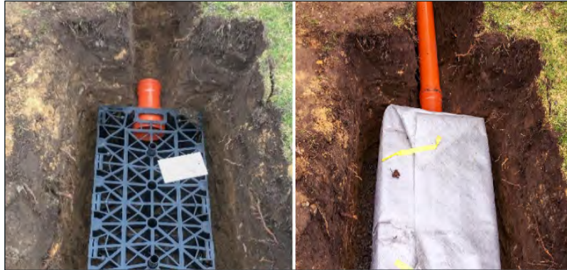
Figur 21. Enkel dagvattenkassett som klätts in i geotextil och ansluten till takavvattning.
